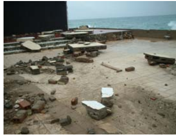
Figura 7. Afectaciones por penetraciones del mar en el litoral de Santiago de Cuba.
